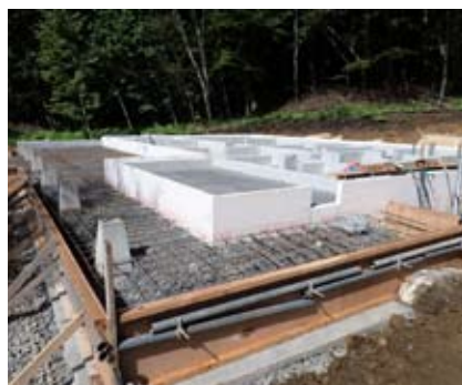
基礎工事がほぼ終わり、10月には木工事がスタートします。(9月23日撮影)
